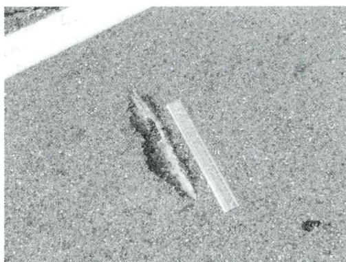
Sl. 3. Poškodba na vozišču (dolžine približno 30 cm), ki jo je povzročila padajoča skala.
