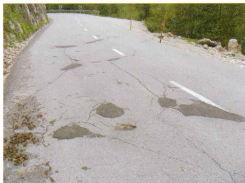
Sl. 4. Poškodba vozišča, kjer so bila nujna obsežnejša vzdrževalna dela (pri žičnici Golobar).
