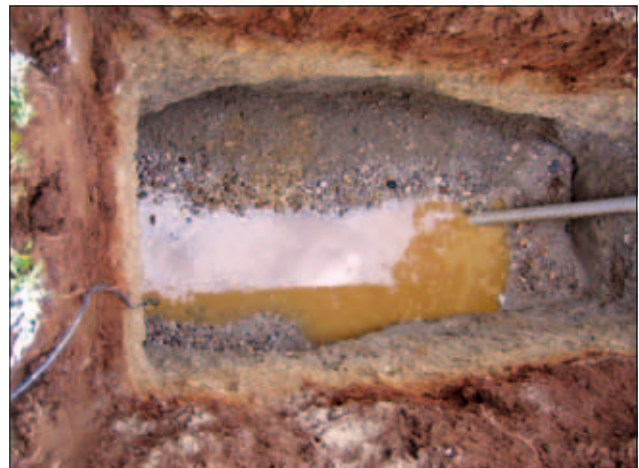
Sl. 5. Primer porušenega izkopa v spodnjem delu izkopa v prodno peščenih plasteh (foto Z. Bole)
